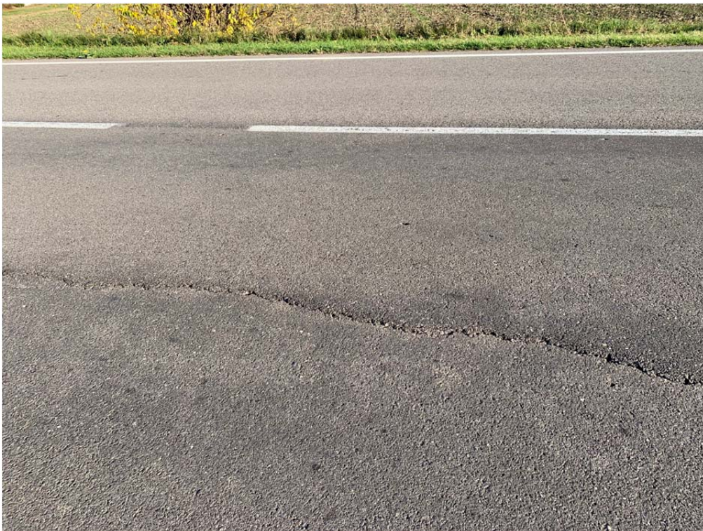
Vista 14 – Via Stradone: area intervento 01 – particolare dei cedimenti
