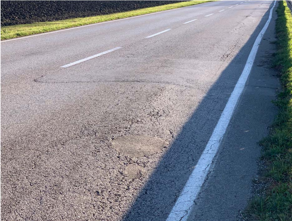
Vista 17 – Via Stradone: area intervento 02 – particolare dei cedimenti
